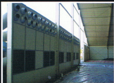
Instalación de aire acondicionado
